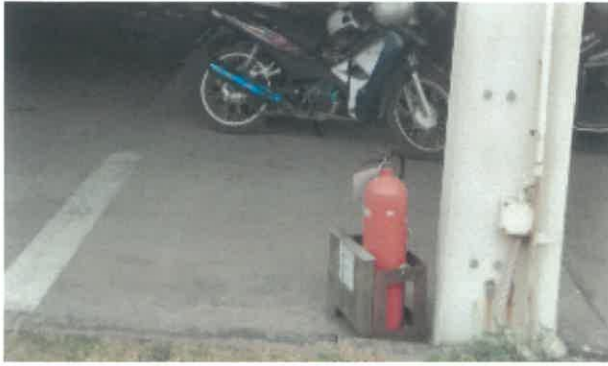
Hình 4. 5. Một số hạng mục phòng cháy chữa cháy của Nhà máy
